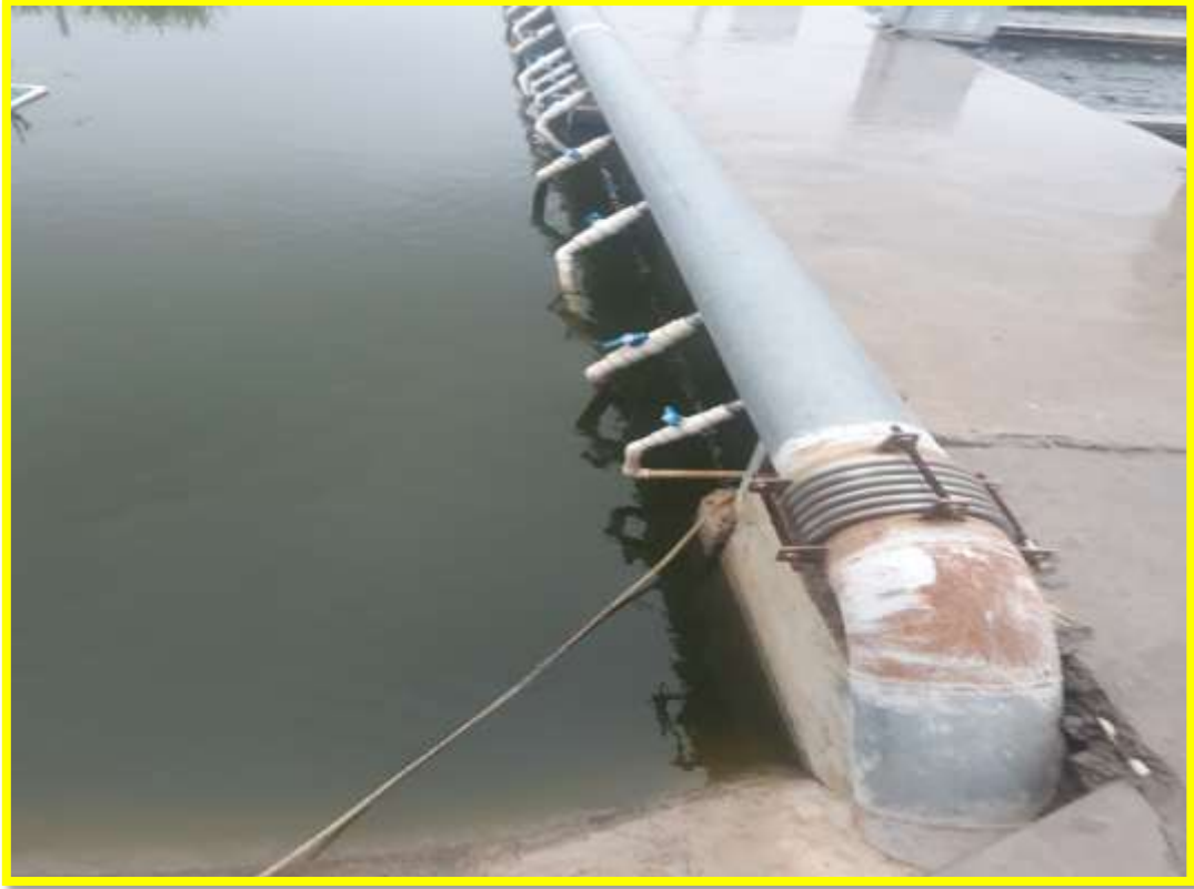
أنابيب ضخ الهواء للأحواض الكونكريتية
